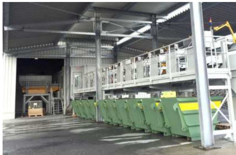
Auf LIBS-Technik basierte Sortieranlage eines Partners
